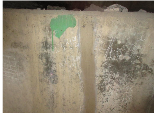
교대 균열(0.3mm미만) A2
