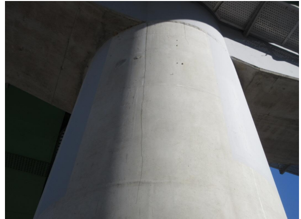
보수현황 상태양호 P2
