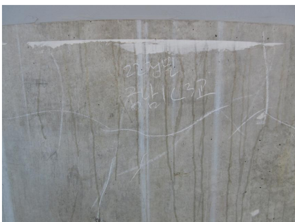
교각 망상균열 P1
